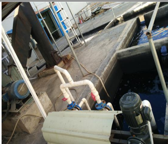
图片 4-1 锅炉喷淋废水循环水池
