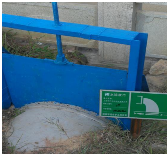
图片 9-10 雨水排放口
