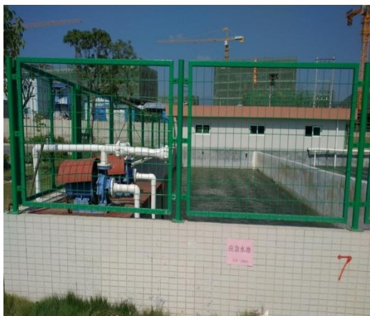
图片 9-13 消防水池
