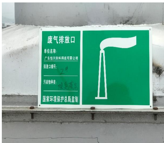
图片 9-6 除臭装置处理设施排放口 2#
