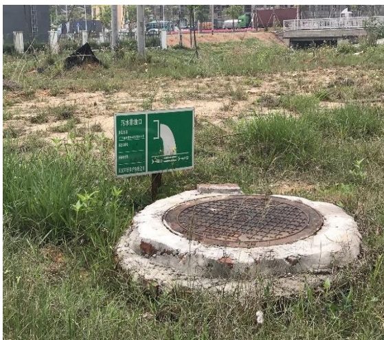
图片 9-9 生活污水排放口
