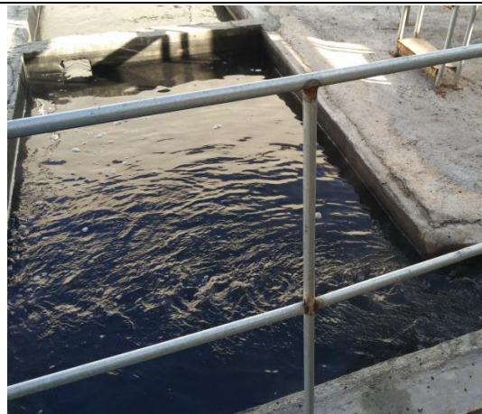
图片 4-2 锅炉排水回用水储存区
