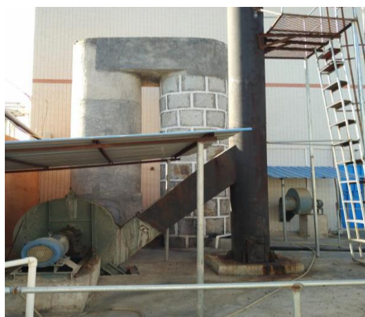
图片 4-18 锅炉废气处理系统
