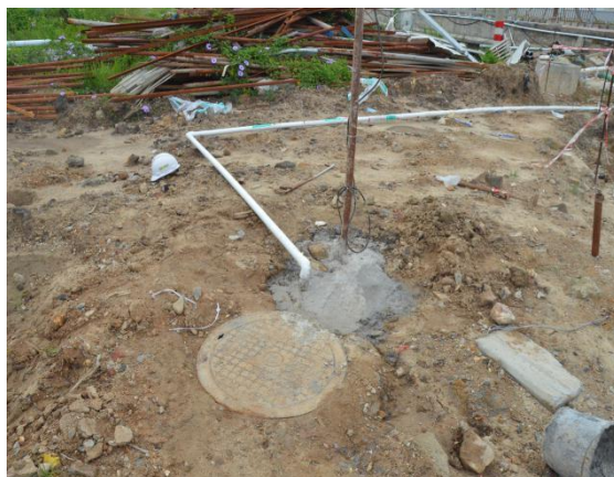
图片 4-4 三级化粪池
