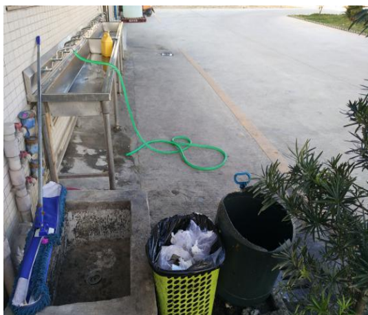
图片 4-5 食堂废水隔油隔渣池
