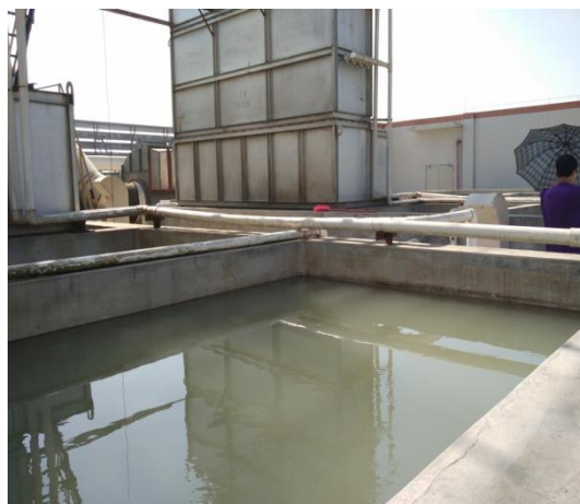
图片 4-14 除臭循环水池
